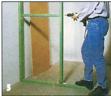
Промежуточную поперечину прибивают к крайней стойке, используя металлический уголок. К внутренней стойке ее крепят шурупами в торец.
